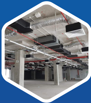
HỆ THỐNG THÔNG GIÓ
